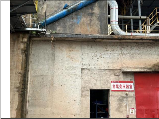
窑尾变压器室 拍摄于 2024 年 11 月 7 日
