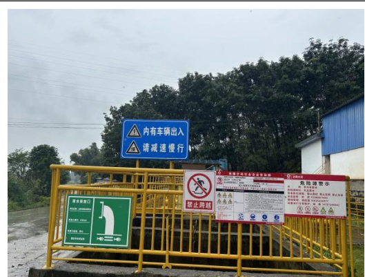
厂区雨污排放口 拍摄于 2024 年 11 月 7 日
