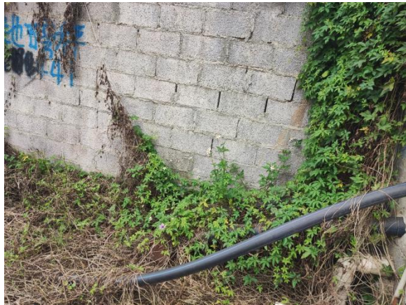
原有项目污水排放管（接入市政管网）
