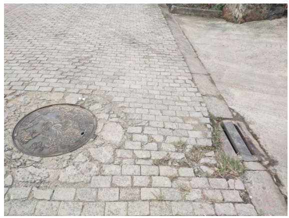
厂界外市政雨水管
