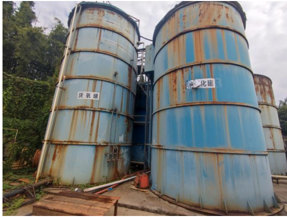
厌氧罐（改造后沿用）
