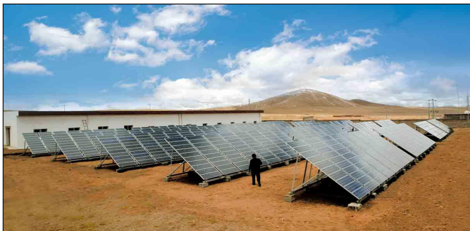
图 2-2 固定式安装运行方式
