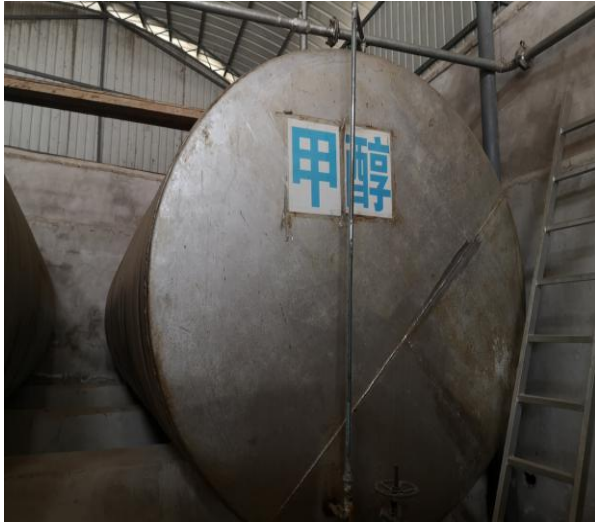
生产车间甲醇储罐
